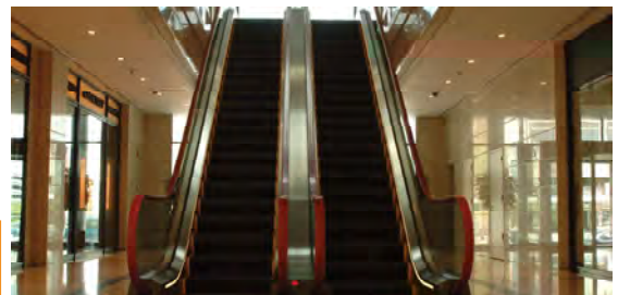
أنظمة النقل بالمباني
