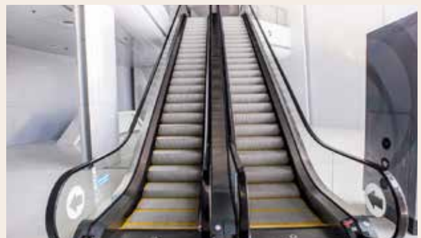
أنظمة مواصلات المباني
